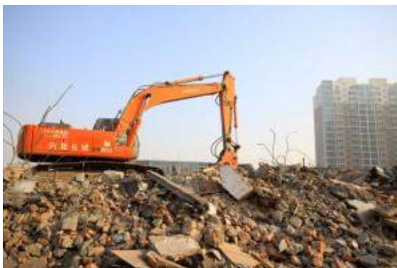
Figura 4. Entulho de construção. Fonte: site Pensamendo Verde (2014).
