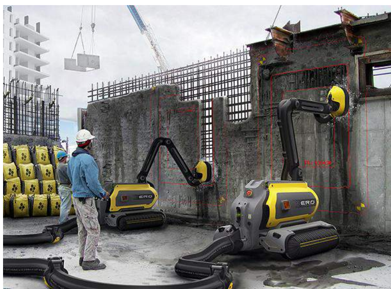
Figura 8: Robô ERO removendo o concreto armado e o reciclando para o uso em peças pré-fabricadas.
