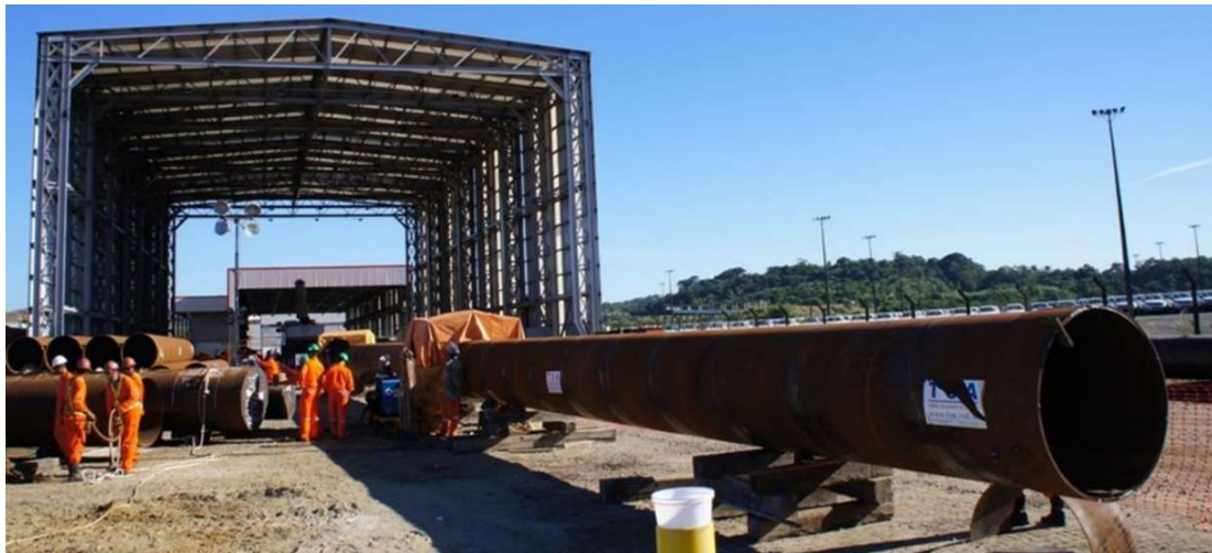
Figura 3.6 – Fabricação de camisas metálicas (corte, preparação e soldas dos tubos fabricados com 18m, camisas chegando ao comprimento de 66m). - Fonte: Arquivos do Consórcio GNL-Bahia.
