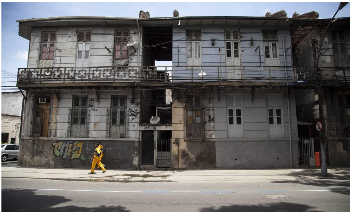
Figura 24: Edifícios da Vila Operária Salvador de Sá – Atualmente, boa parte do conjunto se encontra em preocupante estado de deterioração - 2015. Fonte: O Globo, 2015.
