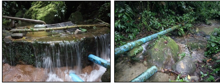
Figura 13 – Captação São Roque.
