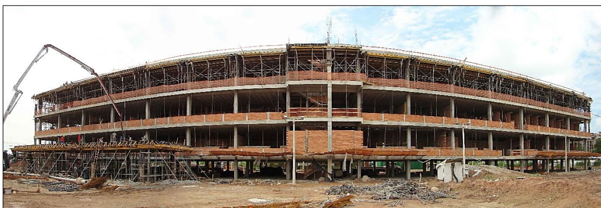
Figura 14 - Execução da Superestrutura e Alvenaria - LADETEC – IQ-UFRJ Fonte: ETU - Escritório Técnico da UFRJ (2014)
