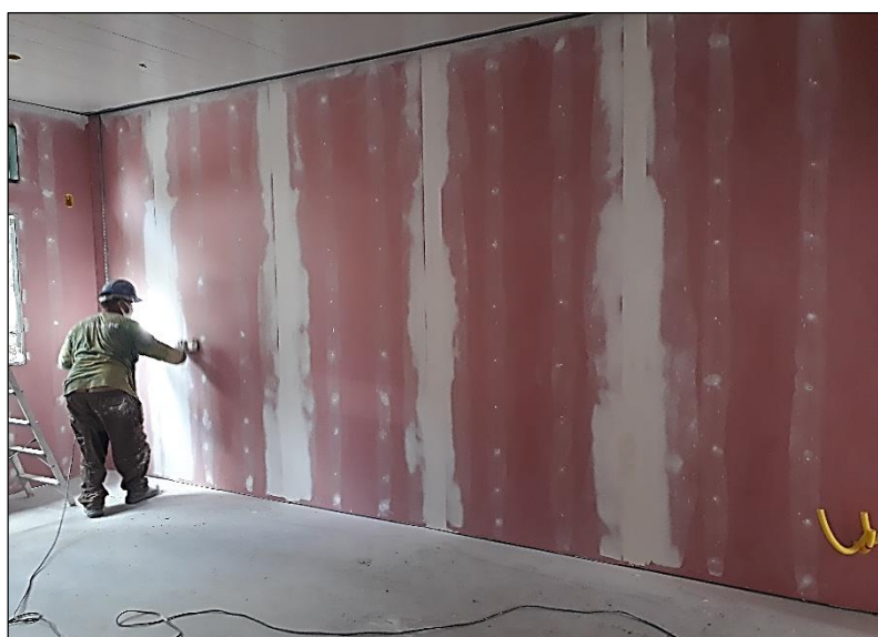
Figura 30 - Placa Resistente ao Fogo (RF) - Prédio Administrativo MN Fonte: O autor (2020)
