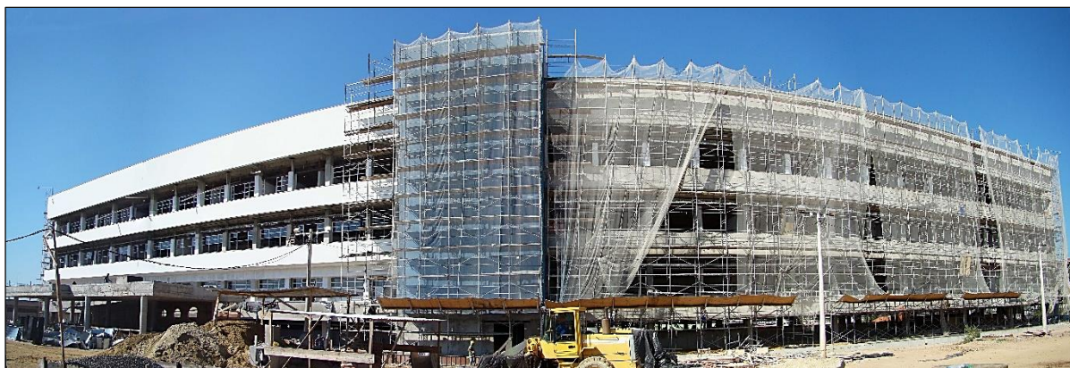
Figura 16 - Execução de Revestimentos Externos e Acabamentos Finais- LADETEC – IQ-UFRJ Fonte: ETU - Escritório Técnico da UFRJ (2014)
