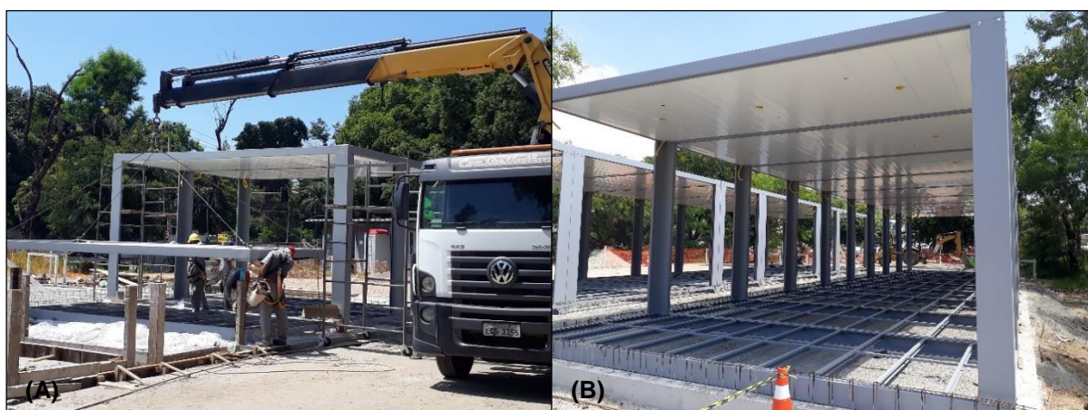
Figura 25 - (A) Transporte, Içamento e Montagem da Estrutura Modular – (B) Módulos Fonte: O autor (2020)
