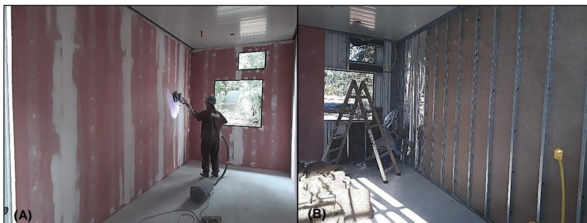
Figura 52 - (A) Divisórias em Drywall – (B) Estruturação em Guias e Montantes Fonte: O autor (2020)
