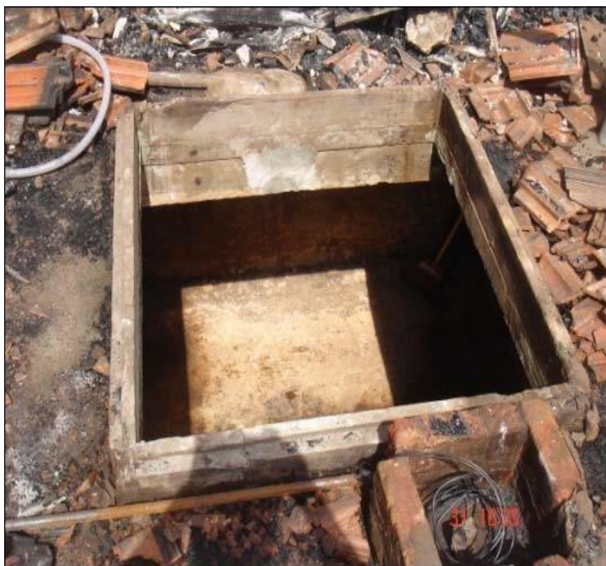
Figura 24 - Reservatório de água, após o incêndio.
