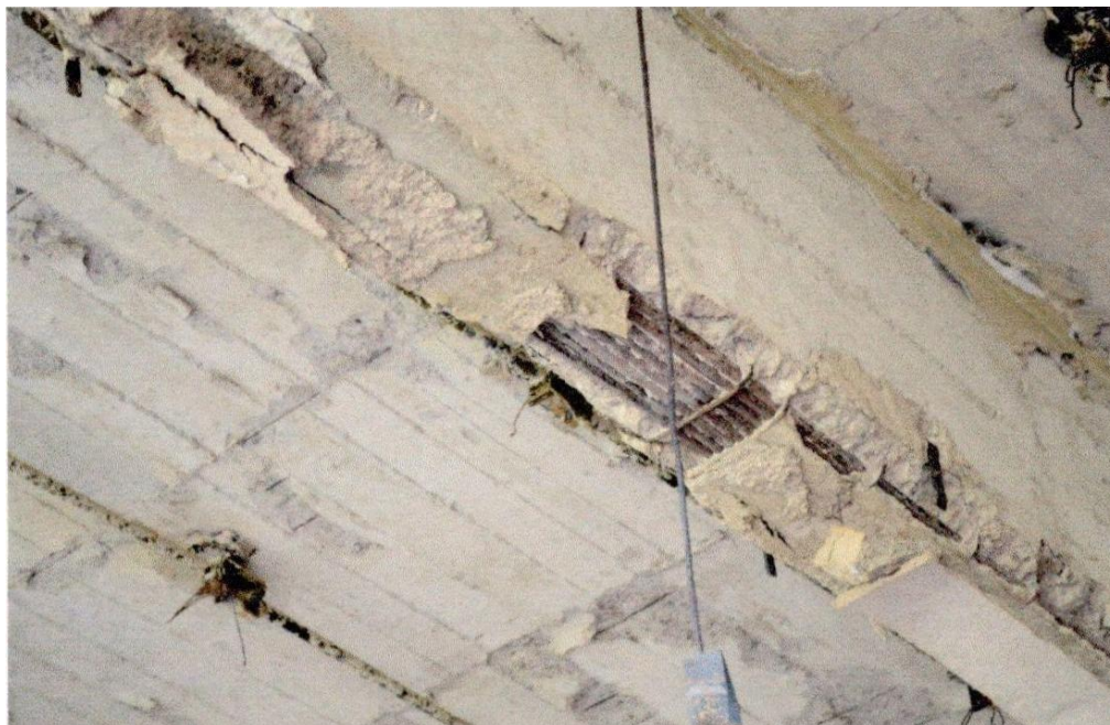
Figura 26 - Intensa destruição das salas do setor sudeste do Bloco A.
