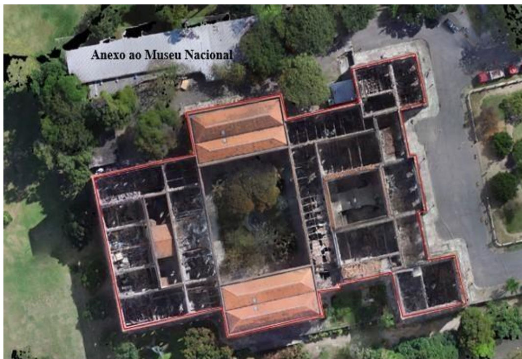
Figura 28 - Área atingida pelo incêndio no Museu Nacional.
