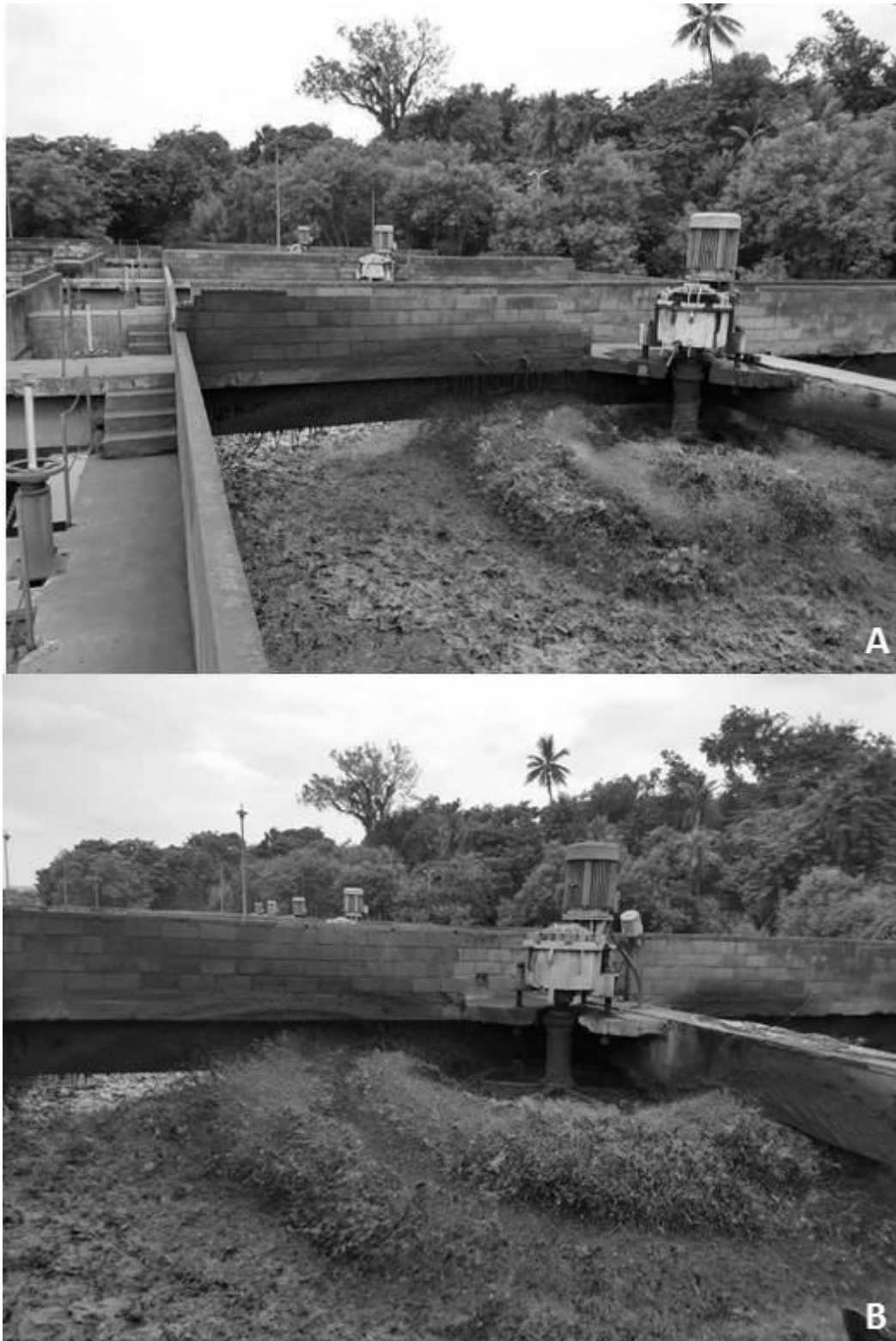
Figuras 3.4 A e B: Tanques de aeração da ETE Penha, destaque para o aerador mecânico de superfície.
