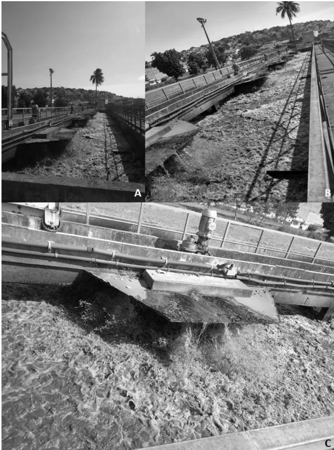
Figuras 3.5 A e B: Tanques de aeração da ETE Ilha; C. Destaque para o aerador mecânico de superfície.
