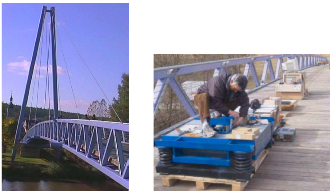
Figura 43 – Vista da passarela Forchheim (esquerda) e instalação do TMD com amortecedor magnetoreológico integrado (direita), MOUTINHO (2007).
