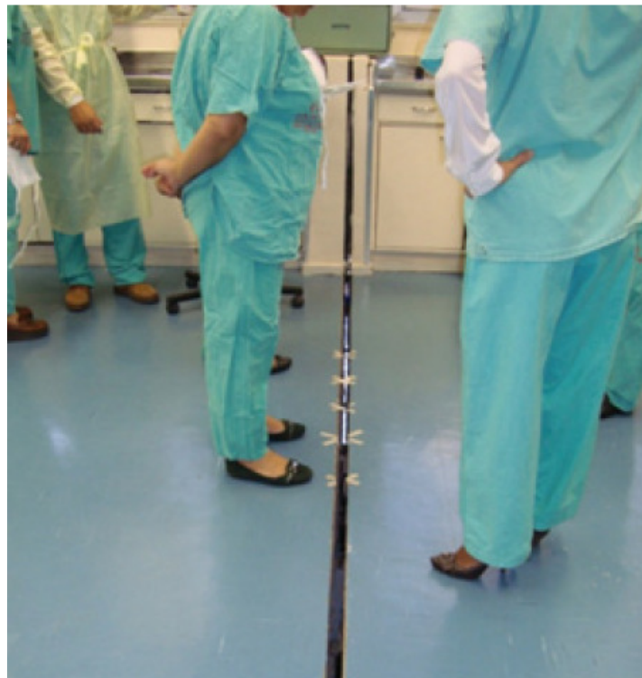
Figura 5.16 – Suposta movimentação da junta de dilatação.
