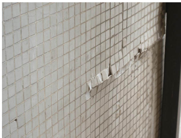
Figura 5.3 – Trinca horizontal de 8 mm.
