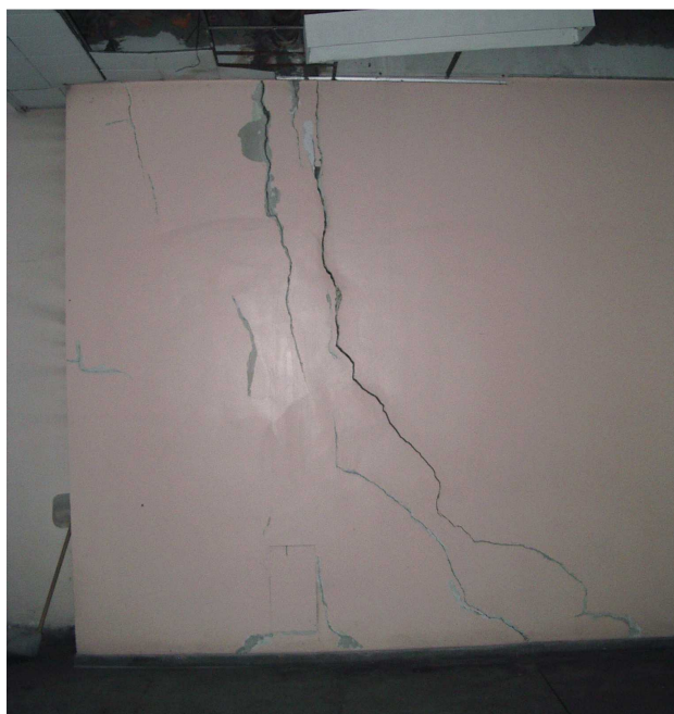
Figura 5.5 – Trinca na parede de alvenaria do refeitório.
