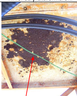
Parte inferior da plataforma com bastante corrosão
