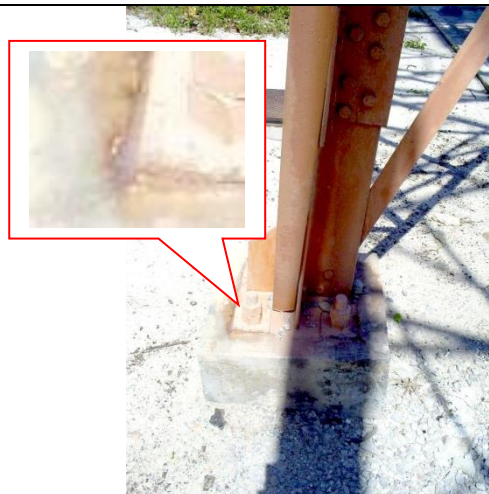
Vista da base D. Pontos de corrosão.
