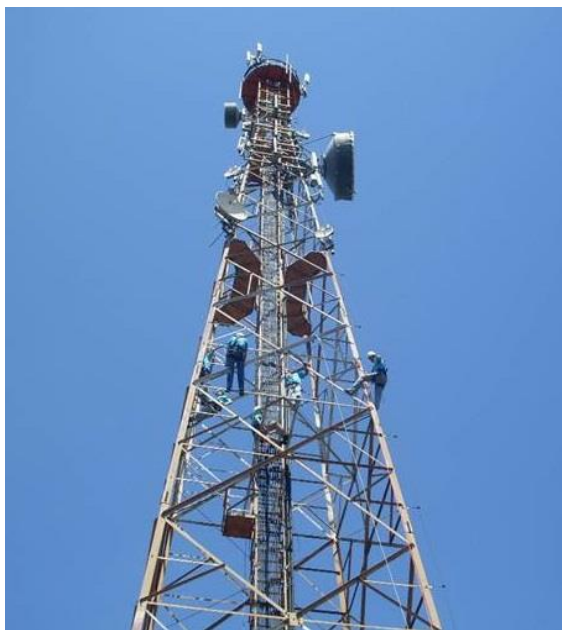
Figura 11: Torre Autoportante com antenas. Fonte: Acervo pessoal do autor.
