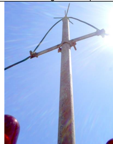
Vista do mastro do pára-raios.
