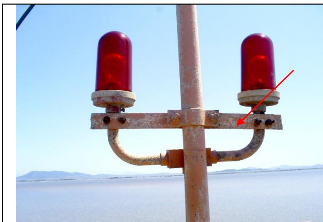
Vista do balizamento, muitos pontos de corrosão.
