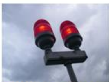
Figura 18: Balizamento de topo
