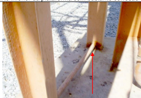
Pé da escada com pontos de corrosão
