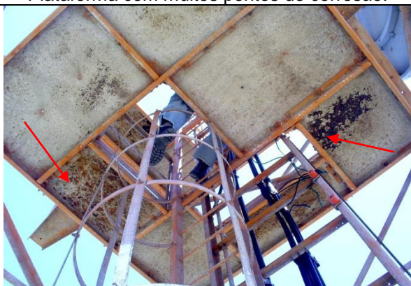
Plataforma com pontos de corrosão
