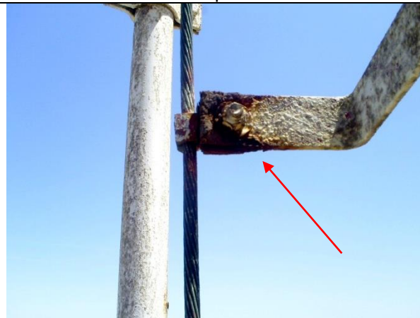
Suporte do cabo do pára-raios com pontos de corrosão.
