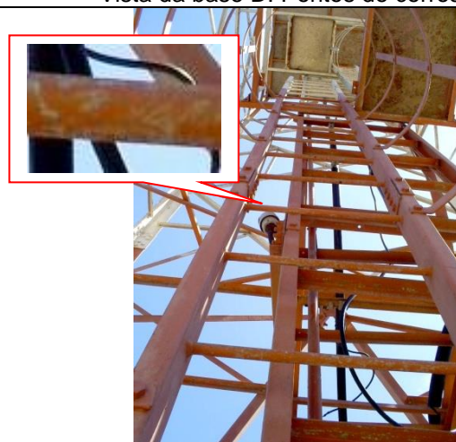
Escada com vários pontos de corrosão.
