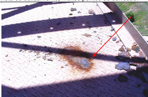
Plataforma com muitos pontos de corrosão.
