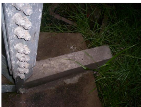
Figura 17: Aterramento das bases da torre protegido por cinta de concreto. Fonte: Acervo pessoal do autor.
