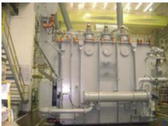
Figura 4.6 – Transformador de potência Fonte: Autor (2010).
