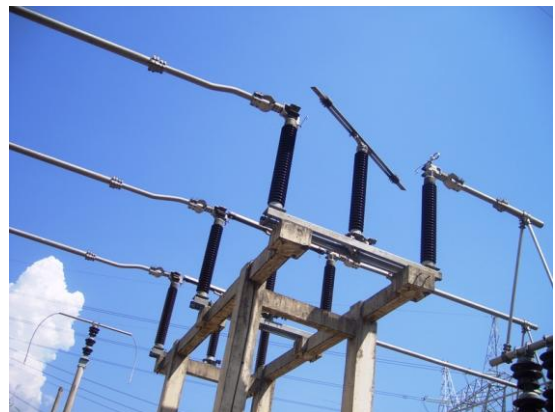
Figura 4.7 – Chave seccionadora e condutores Fonte: Autor (2010).
