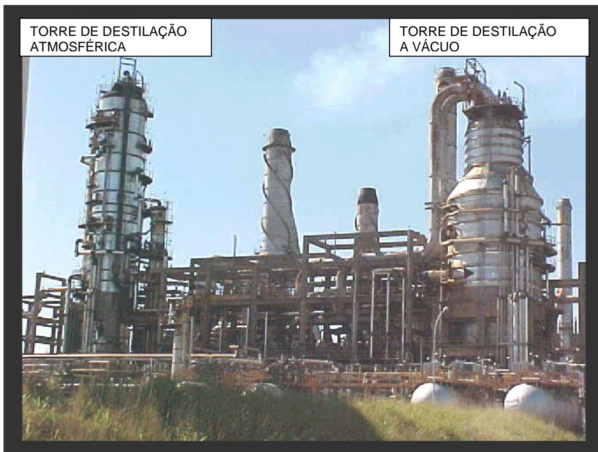
Fig. 5 Área composta. Destilação Atmosférica e a vácuo Fonte: www.google.com.br/imagens+torres de destilação
