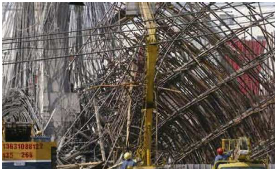
Figura 5 - Colapso de escoramento na National Road 107, em Zhengzhou-China
