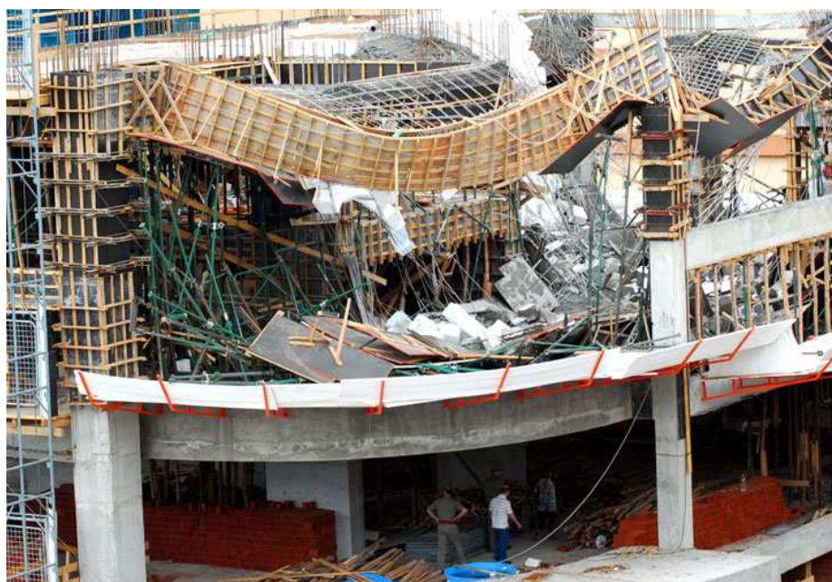
Figura 6 - Colapso de escoramento de um shopping, em Passo Fundo-RS
