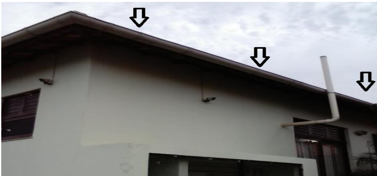
Figura 12 - Calhas de captação da água da chuva para reaproveitamento no campus Rio Paraíba do Sul. Autora: Aline Oliveira (2015)
