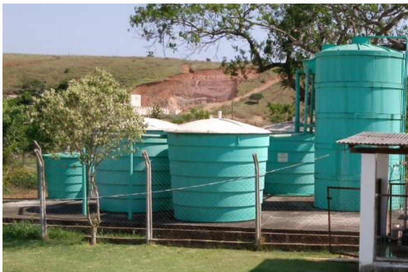
Figura 7 - Estação de Tratamento de Efluentes Líquidos Sanitários do campus Itaperuna. Autora: Aline Oliveira (2015)
