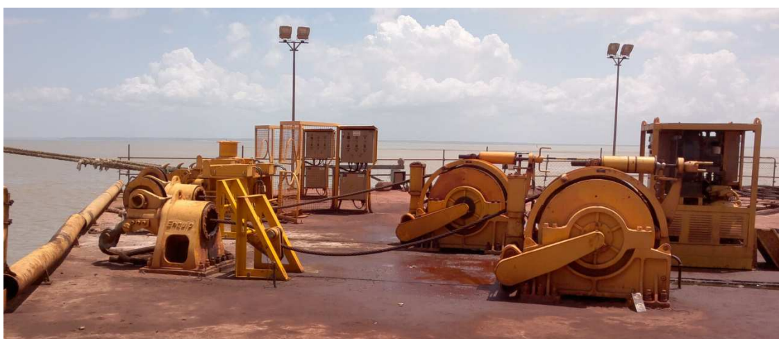
Figura 2-12– Equipamentos de Amarração Instalados no Dolfim D7 e D8 – Guinchos e Gatos.
