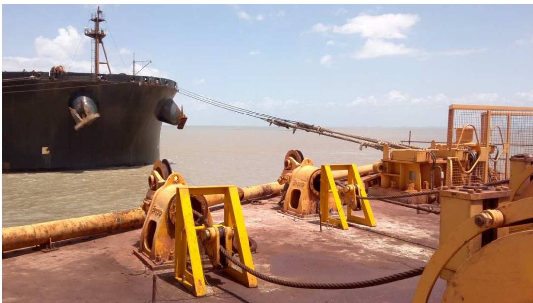
Figura 2-11 – Equipamentos de Amarração Instalados no Dolfim D7 e D8 – Guinchos e Gatos.
