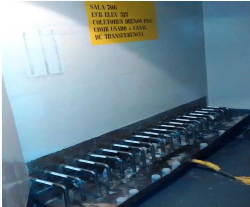
Figura 7: Foto da Saída dos 19 pontos de drenos, EL. 5,15
