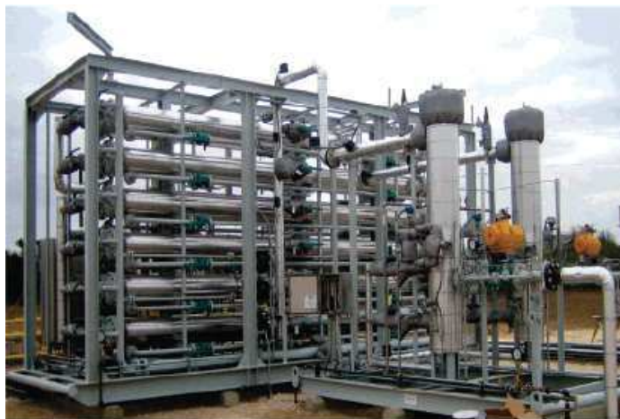
Figura 12 - Unidade Industrial de Remoção de CO 2 por Membranas
