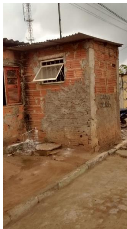
Figura 49 – Detalhe do banheiro sobre a calçada Fonte: Disciplina Materiais Alternativos Aplicados à Arquitetura e Urbanismo - 2016
