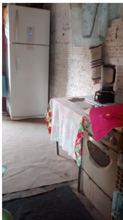
Figura 48 – Detalhe da cozinha que não possui pia
