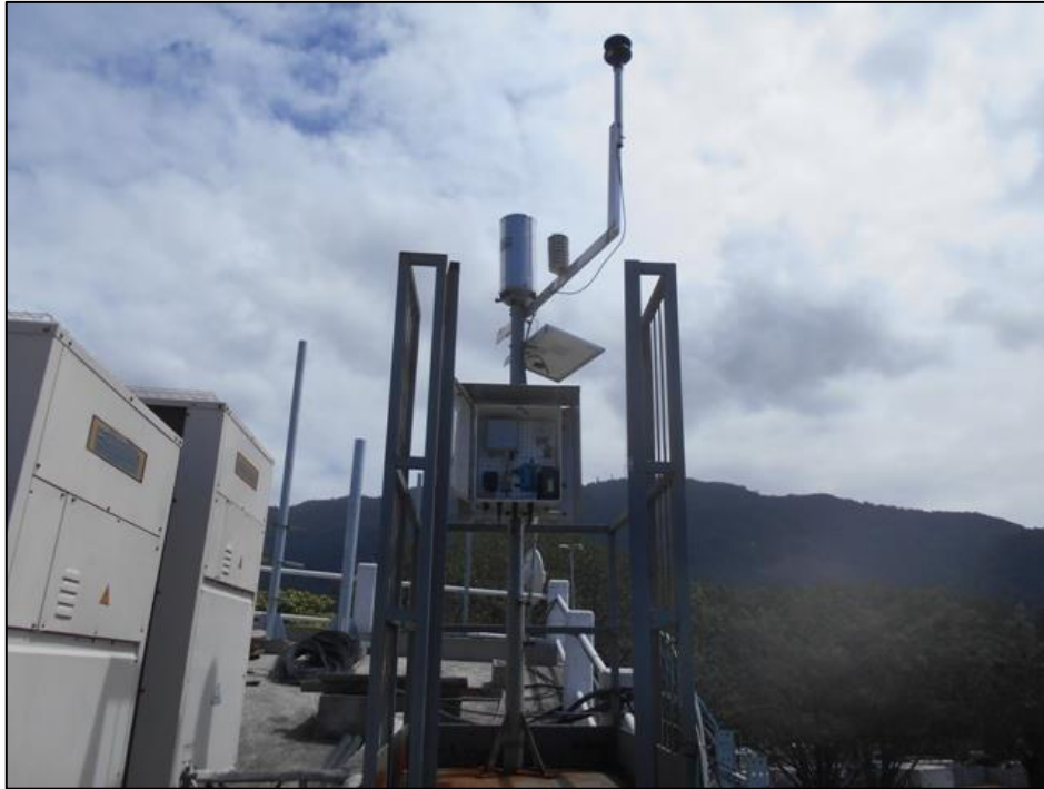
Figura 8 - Estação meteorológica instalada no Estádio de Remo. Fonte: Foto cedida pela empresa TECMA em 2017.
