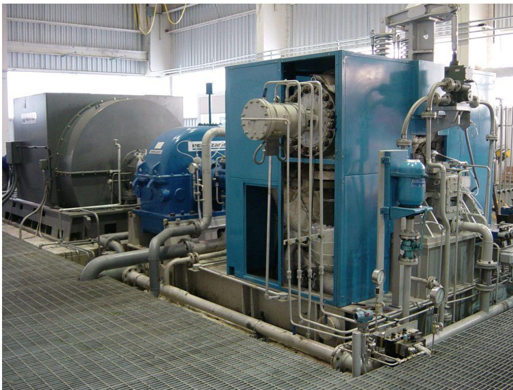
Figura 2.1 – Turbo gerador e sua fundação.
