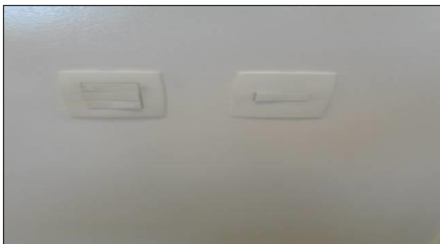
Figura 19 – Fotografia de interruptores seccionados.
