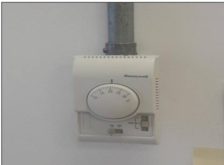
Figura 24 – Fotografia do regulador manual de temperatura.
