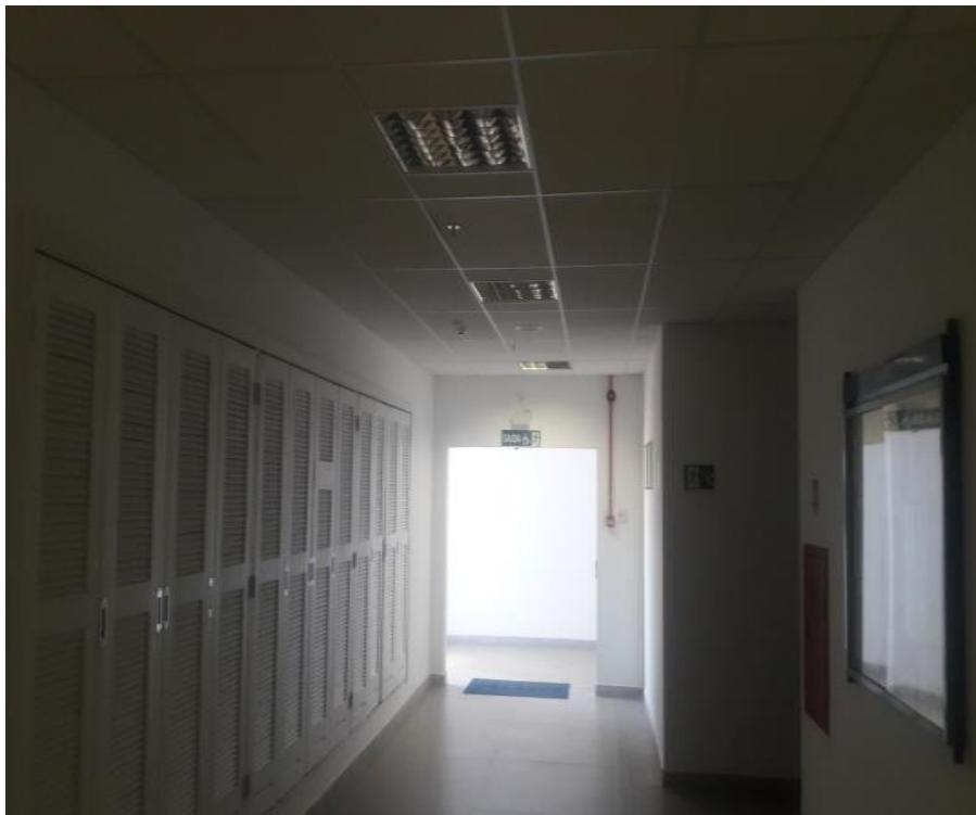
Figura 18 – Fotografia do corredor com luzes apagadas.
