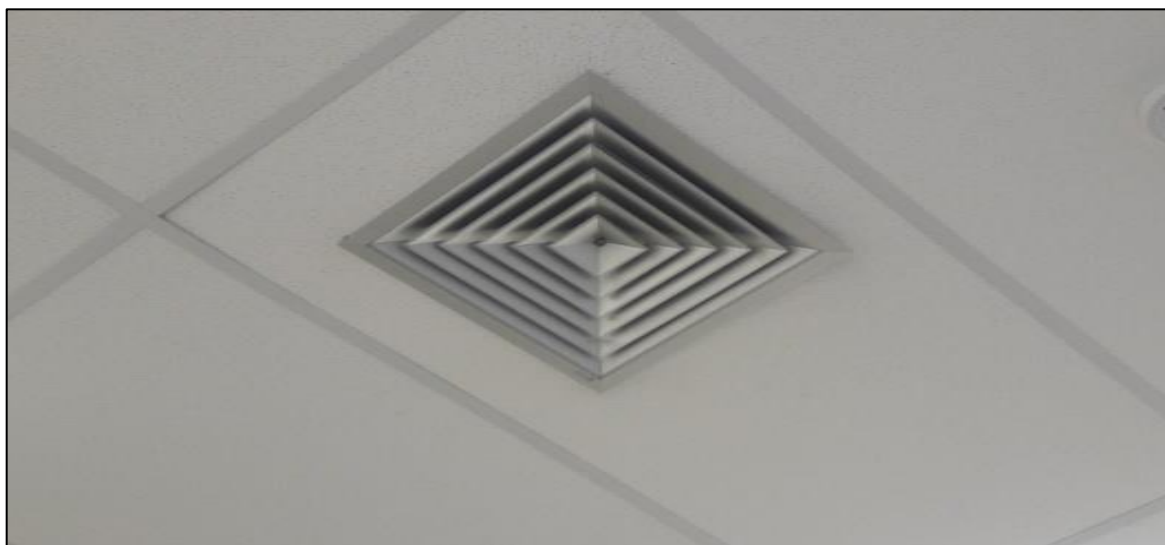
Figura 23 – Fotografia das grades de ventilação do LADETEC, UFRJ.
