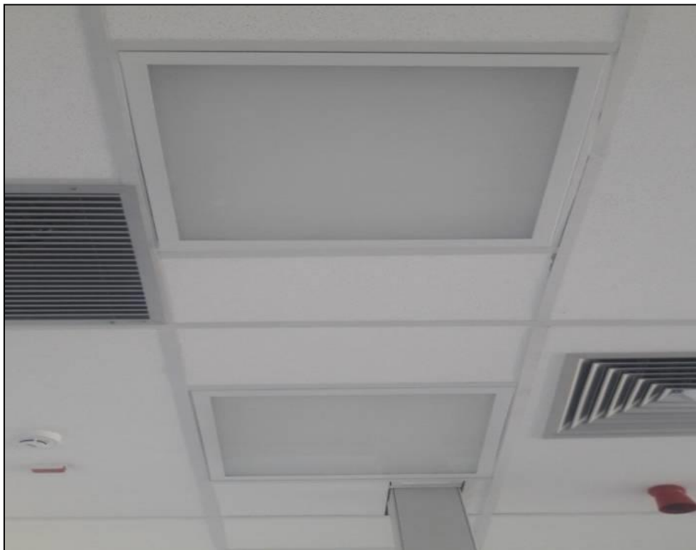
Figura 14 – Fotografia de luminária com difusor.
