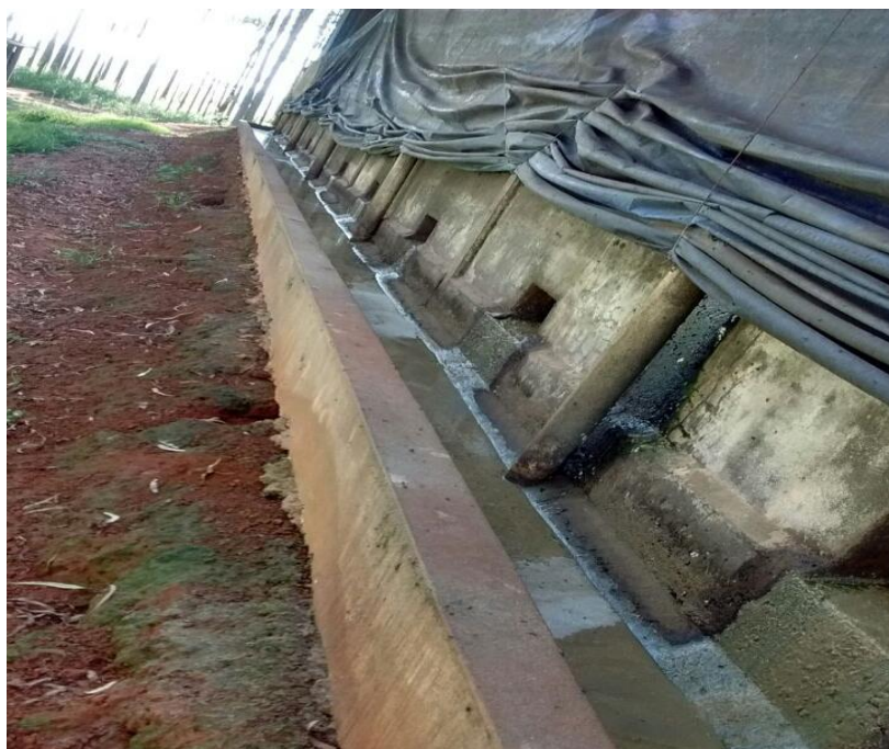
Figura 19 - Transporte do esterco por canais de concreto atrás do confinamento. Fonte: Autor.
