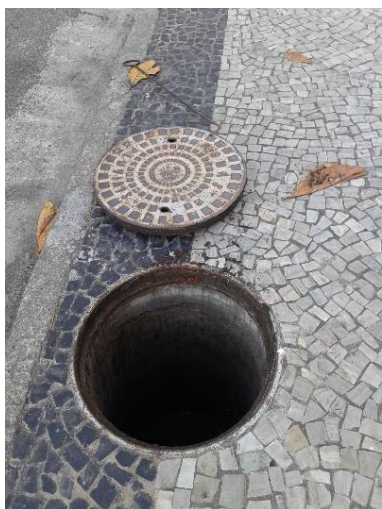
Figura 18 Poço de Inspeção no Ponto de Coleta 2. Escrita “Águas Pluviais” na tampa.
