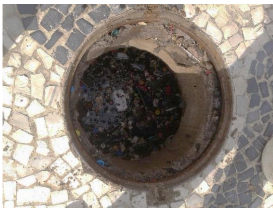
Figura 16: Acúmulo de resíduos sólidos em galeria pluvial. Localizado próximo ao Ponto 1 de coleta.
