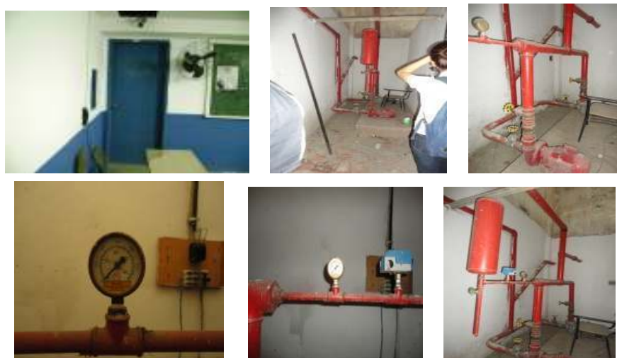
Figura 15: Bombas da rede preventiva (seis fotos)
