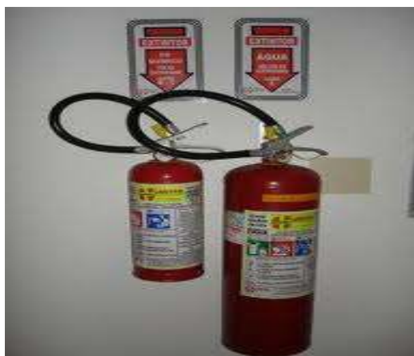
Figura 17: Sinalização de incêndio rede móvel
