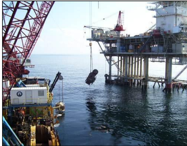
Figura 11 - Descomissionamento de plataforma offshore .
