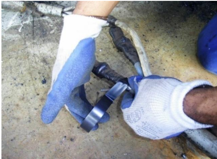
Foto 33 – Manutenção do isolamento do cabo elétrico. Fonte: o autor.
