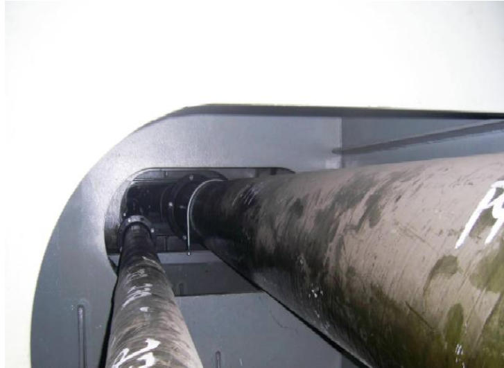
Foto 18 – Tubulação no fundo duplo da embarcação. Fonte: o autor.
