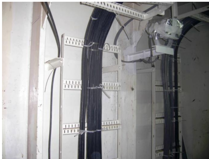
Foto 38 – Cabos elétricos na calha.
