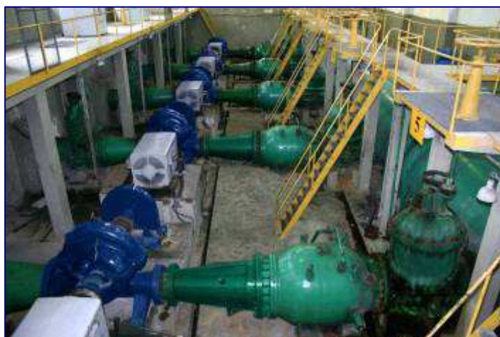
Figura 4.8: Cinco conjuntos motobombas da EE ARG Fonte: CEDAE, 2011.
