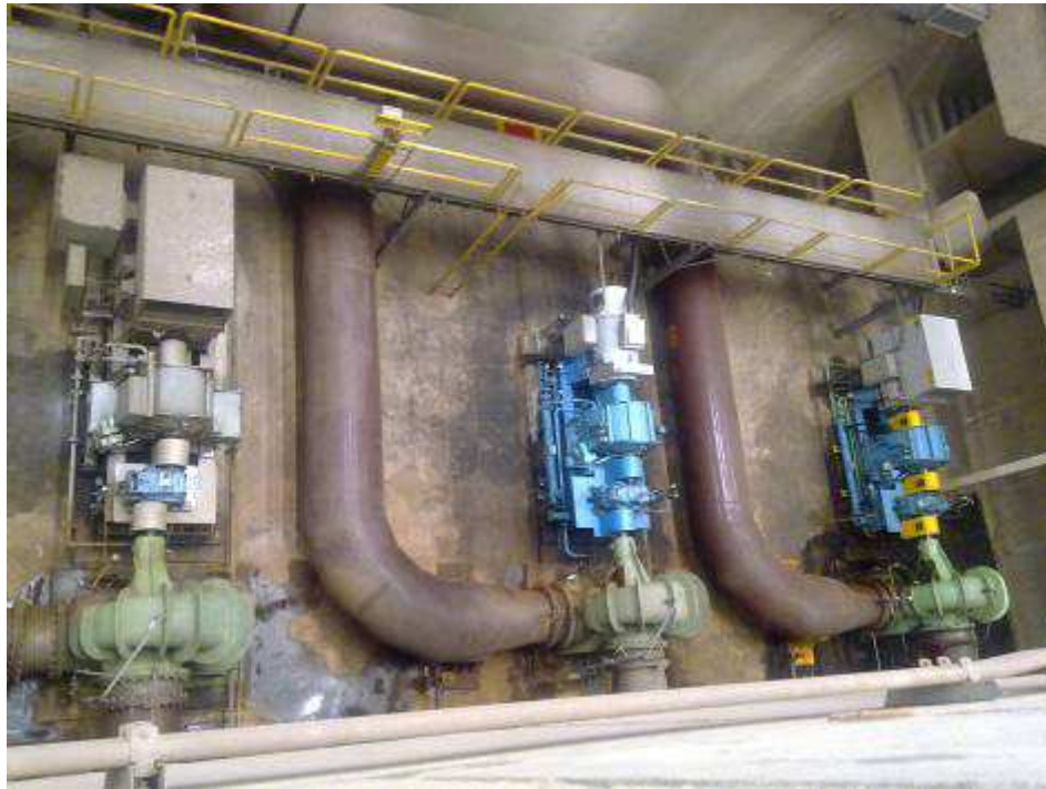
Figura 4.2: Conjuntos motobombas com HCs na EE Final, ETE ABC Fonte: Sabesp, 2011.
