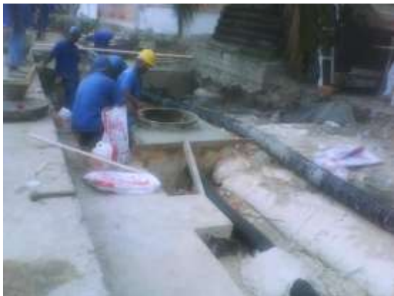
Fig. 31 – Caixa de passagem e envelopamento de tubulações.
