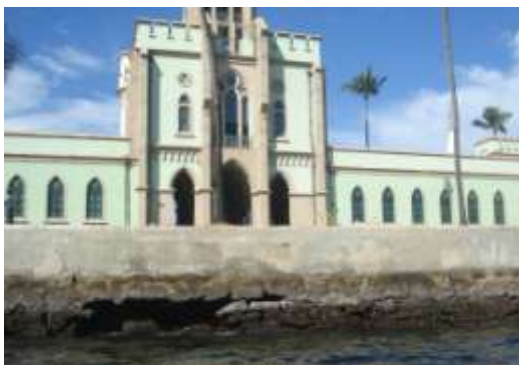
Fig. 5 – Falhas no paramento do cais.
