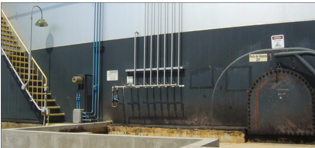
Fig. 3.45: Diversos acessórios e aberturas de tanques de armazenamento (da esquerda para a direita): escada helicoidal, indicador do medidor de nível, amostrador de costado e porta de limpeza.
