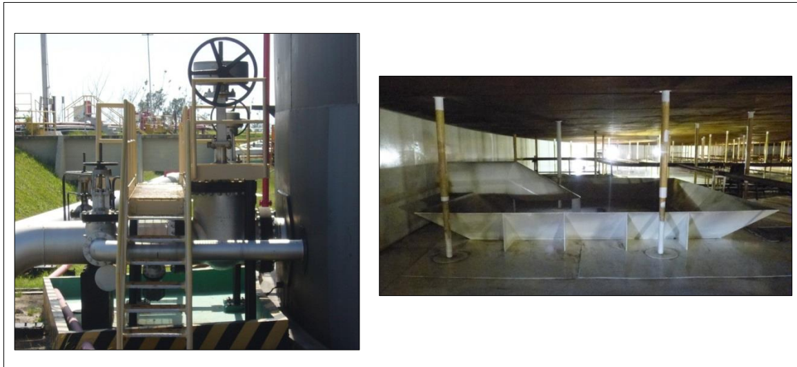
Fig. 3.46: Bocais de entrada (tipo sifão) em tanques de aço: aspectos externos (esq.) e internos (dir.).
