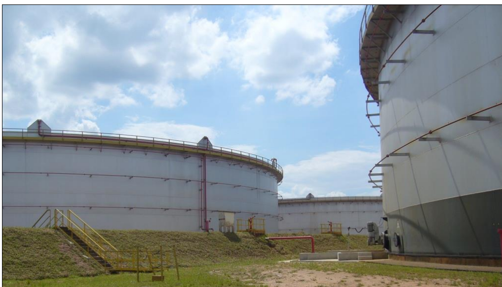
Fig. 2.1: Tanques de armazenamento em aço carbono.
