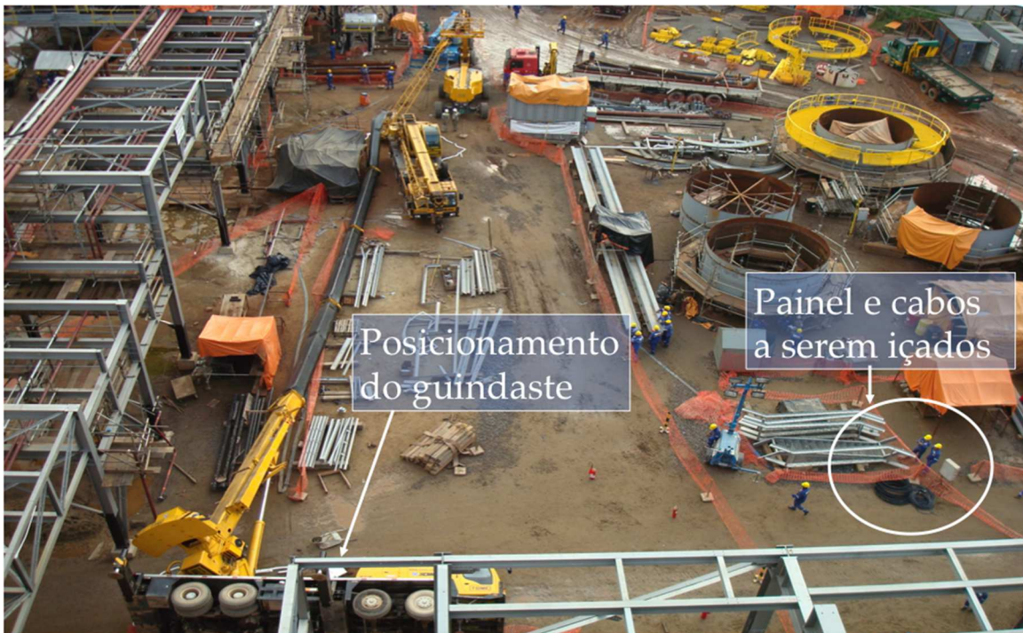
Figura 4.2-2: Guindaste caminhão XCMG QY50K tombado (arquivo pessoal)
