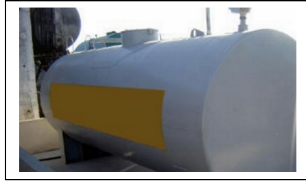
Figura 3: SAAC – tanque aéreo disposto em uma bacia de contenção. Fonte: RS Instalações (2012).
