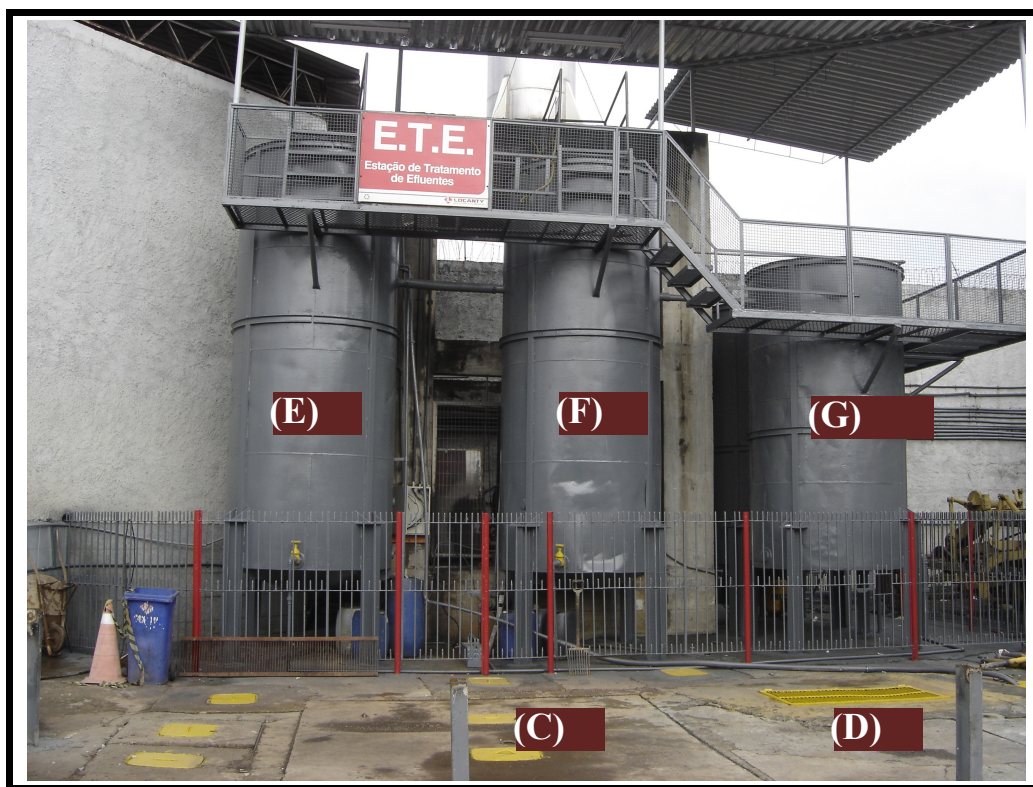
Figura 2.3 – (C) Caixas separadoras de óleos e graxas, (D) Calha Parshall, (E) Tanque de coagulação, (F) Tanque de floculação e (G) Tanque de sedimentação da ETE em estudo.
