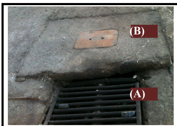
Figura 2.2 – (A) Gradeamento e (B) caixa de retenção de sólidos grosseiros da ETE em estudo.
