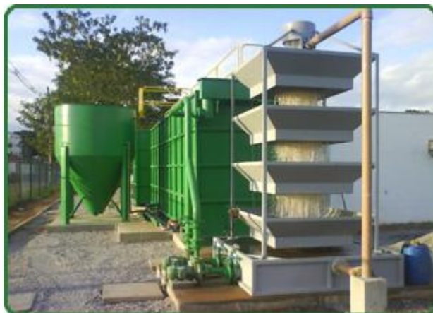
Figura 3 - Estação de tratamento de Água CDN/ GALEAO
