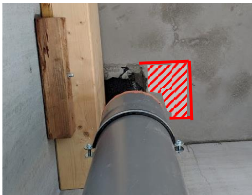
Figure 42 : réservation posée à la moitié sur une poutre.
