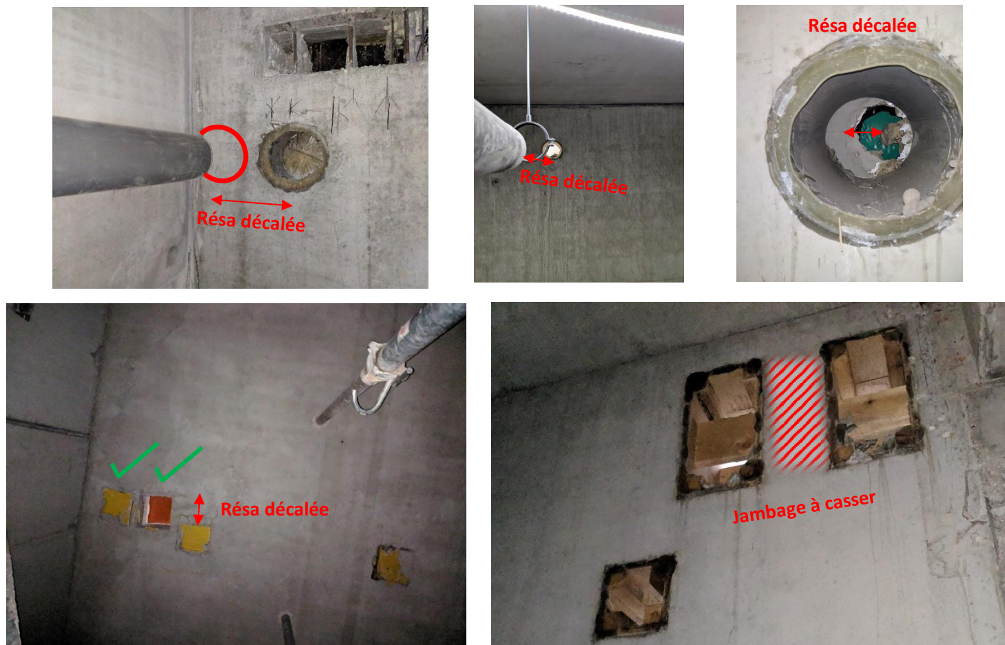
Figure 35 : erreurs rencontrés dans les réservations (sous-sol site 2).
