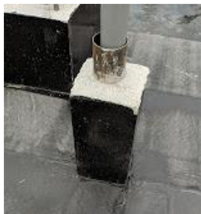
Figure 48 : relevé autour de réservation de VMC.
