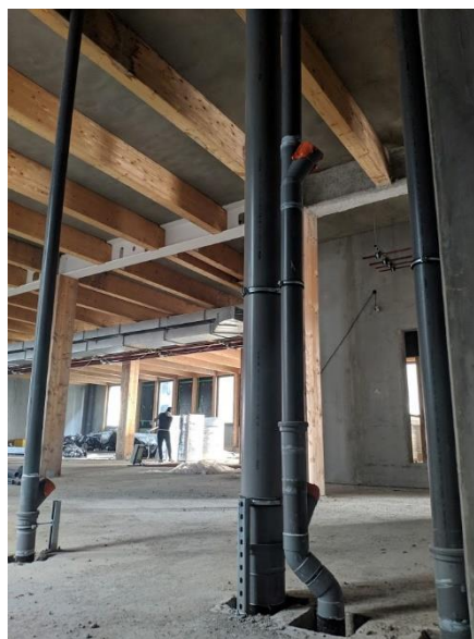
Figure 26 : tuyaux de plomberie passés par Clevia.
