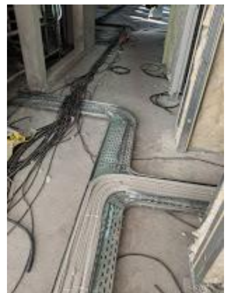
Figure 27 : chemins de câble passés par Eiffage Energies.
