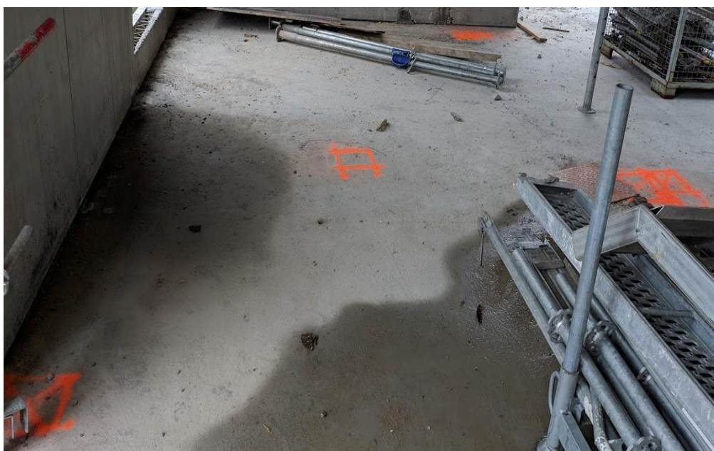
Figure 44 : en orange, l'emplacement des réservations posées dans les prédalles mais oubliées dans la dalle de compression.
