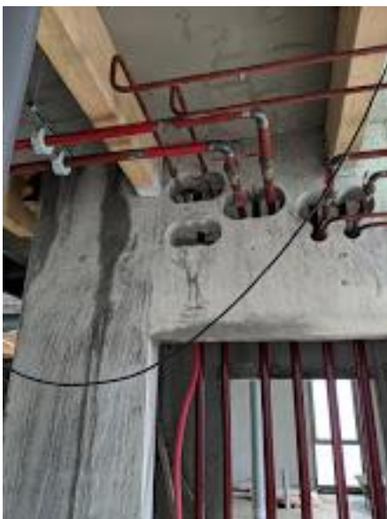
Figure 25 : tuyaux de CVC passés par Clevia.
