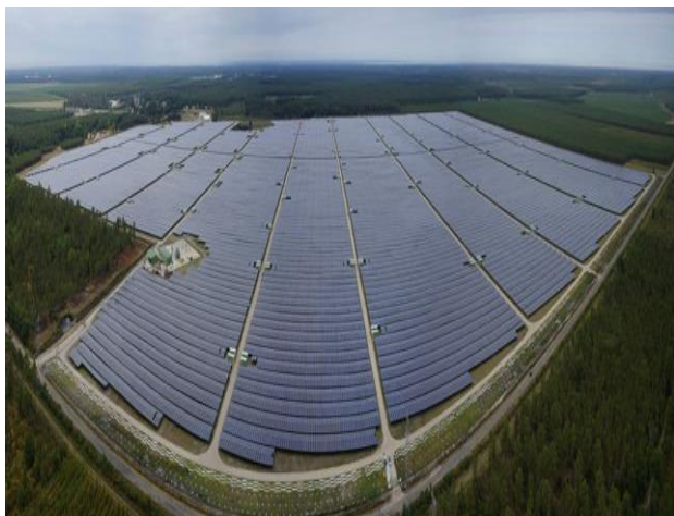
Figure 5 : Centrale solaire de Cestas.
